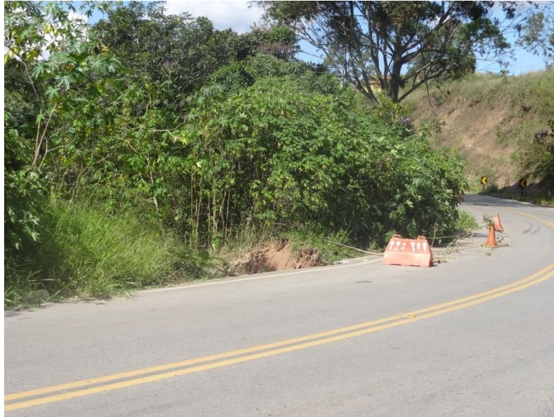
Figura 32. Trecho da estrada Mário Covas com desabamento, presença de espécies exóticas (à frente) e nativas pioneiras (ao fundo), em APP, Área Norte do município de Mairinque, SP.
