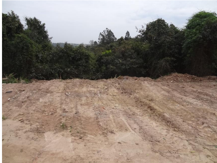
Figura 58. Alargamento da estrada de terra em APP, Área Norte do município de Mairinque, SP. Coordenadas Geográficas UTM: 23S 264526 7403570.
