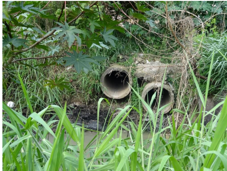
Figura 15. Possível despejo de efluentes domésticos no Rio Varjão e presença de gramíneas na APP, Área Central do município de Mairinque, SP. Coordenadas Geográficas UTM: 23S 275827 7394938.
