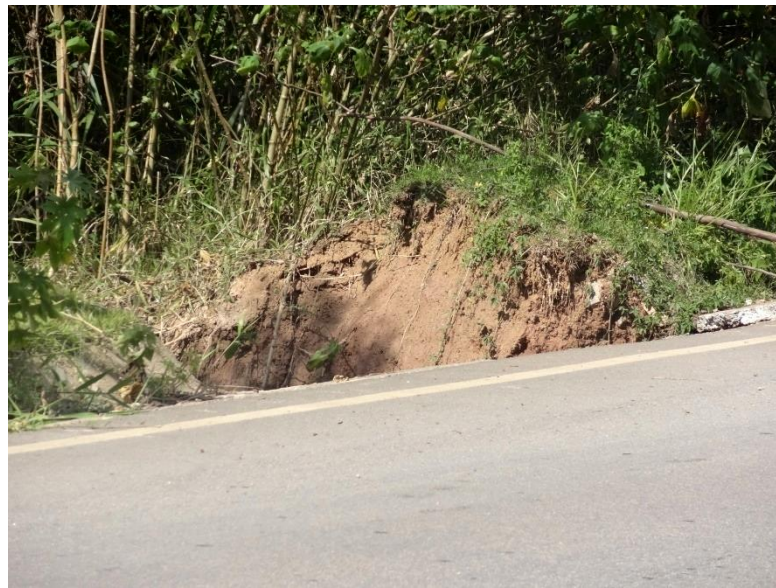
Figura 31. Trecho da estrada Mário Covas com desabamento devido às intensas chuvas em APP, Área Norte do município de Mairinque, SP.
